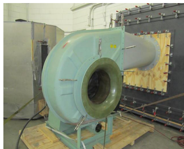
図3 吐出側を設置した供試送風機 (FTF503)
