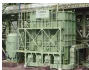
BB形 (生物脱臭塔)
